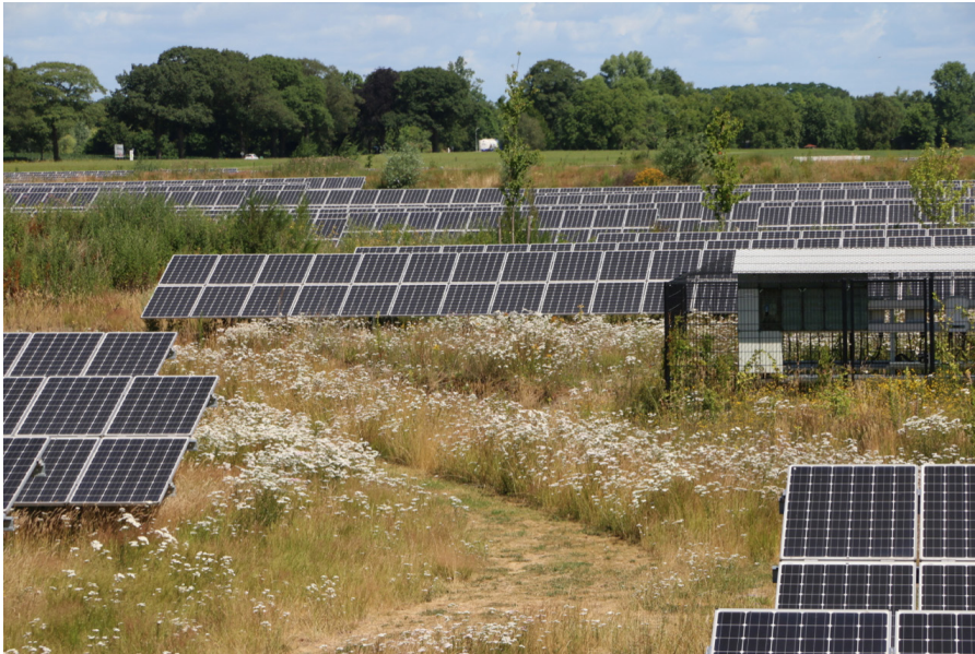
Ruimte voor ecologische inpassing van de panelen
