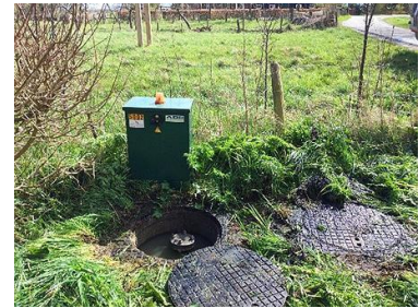
Drukrioolgemaal in het buitengebied.
